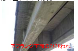
下フランジ下面のひびわれ
