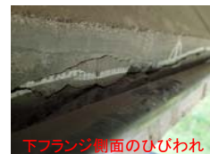
下フランジ側面のひびわれ
