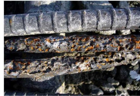
RCホロースラブ橋主版上面鉄筋のマクロセル腐食
