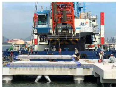
ジャケット式栈橋床版 中国地方整備局宇野港湾事務所
