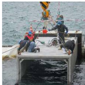
ボックスカルバート 九州地方整備局下関港湾事務所
