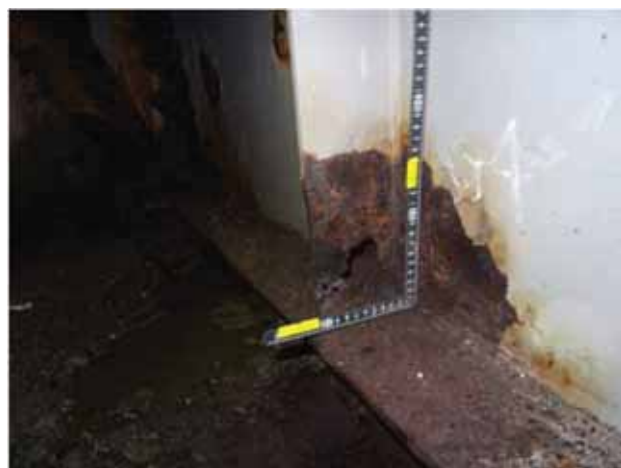
国管理 主桁腐食・欠損
