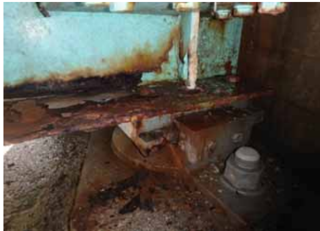
地方自治体管理 主桁腐食
