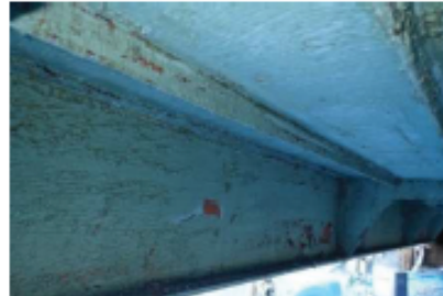
桁の塗装劣化やさびの発生
