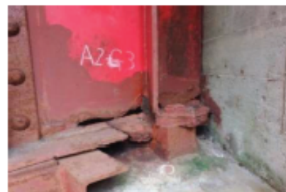
桁端部の腐食・貫通
