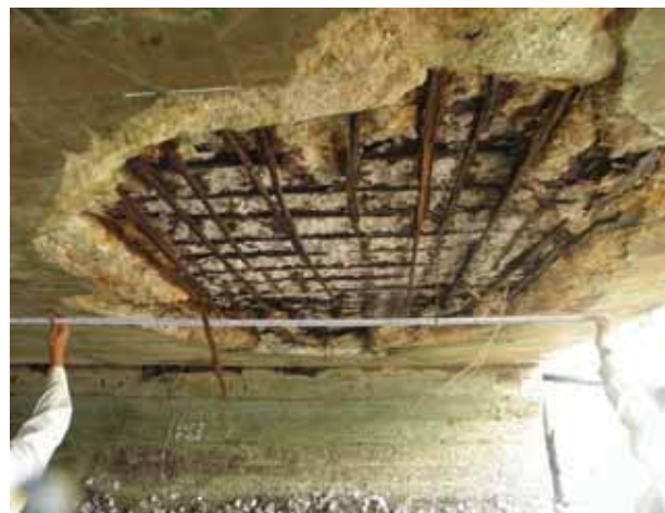
地方自治体管理 床版鉄筋露出
