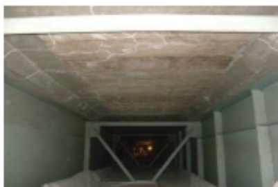
ひび割れの発生
