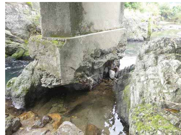
地方自治体管理 橋脚洗掘
