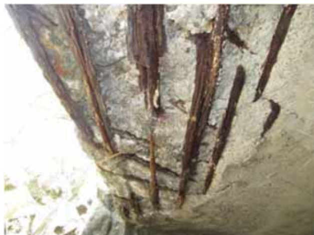
国管理 床版鉄筋露出
