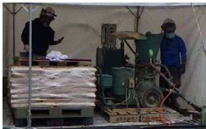
吹付けプラント
