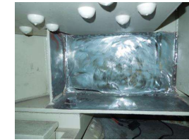
補強前(ケレン後)
