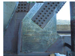
補強前(ケレン後)
